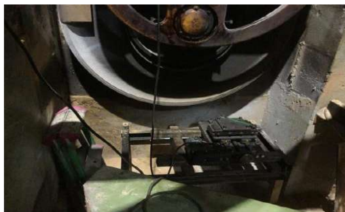
製材機械のプーリー部分（下部）
