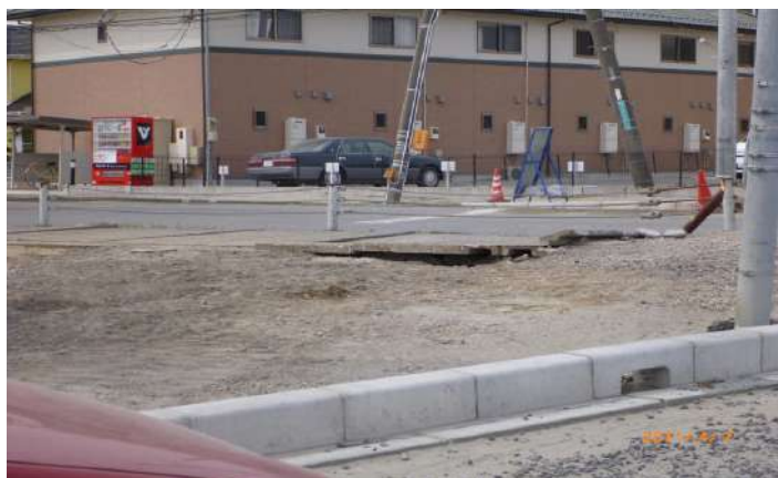
道路がいたる所で大きな亀裂が走っている
